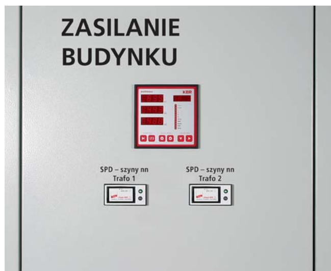
Rys. 4. Zabudowa paneli w drzwiach szafy rozdzielczej
