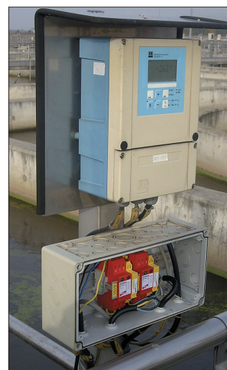
Fot. 5 Ochrona przed przepięciami stanowiska pomiarowego
