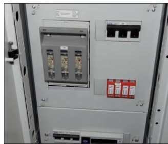
Rys. 5. Rozdzielnica oddziałowa w układzie przemysłowym – SDP typu 2 z prawidłowo dobranym dobezpieczeniem
