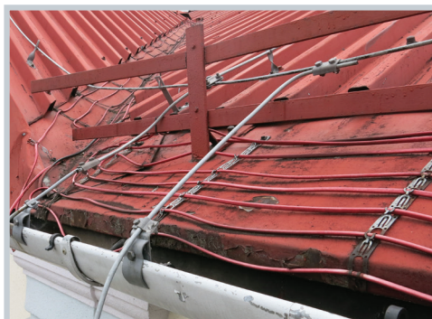
Rys. 7. Niezachowany odstęp izolacyjny w warunkach rzeczywistych
