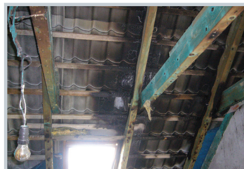
Rys. 8. Zniszczona instalacja elektrycznym w wyniku przeskoku iskrowego spowodowanego brakiem odstępu izolacyjnego a instalacjami wewnętrznymi
