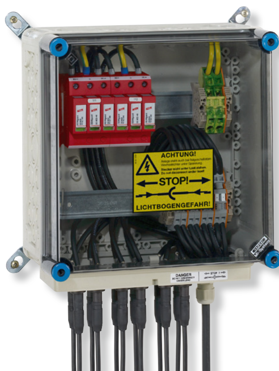
Rys. 2. Ochrona przepięciowa w szafce przyłączeniowej generatora PV
