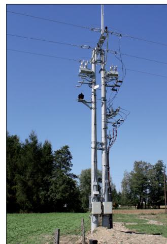
Rys. 1. Reklozer zainstalowany na linii napowietrznej SN
