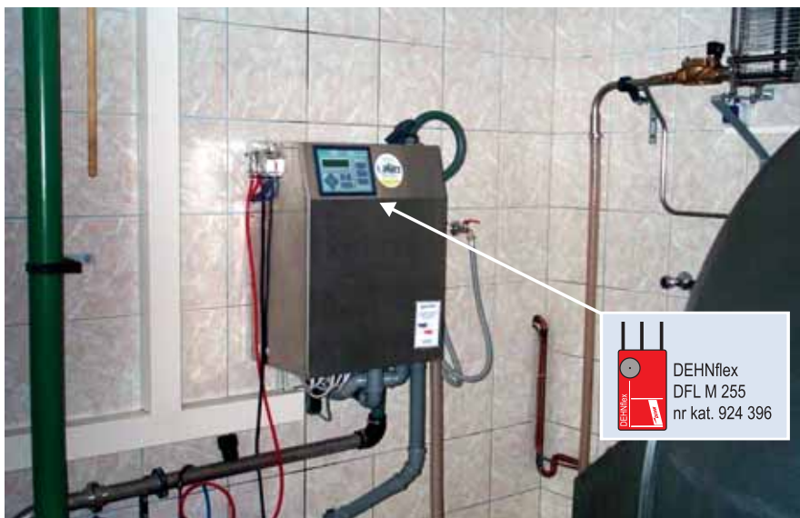
Rys. 3. Elektronie sterowana instalacja przewietrzania i splukiwania
