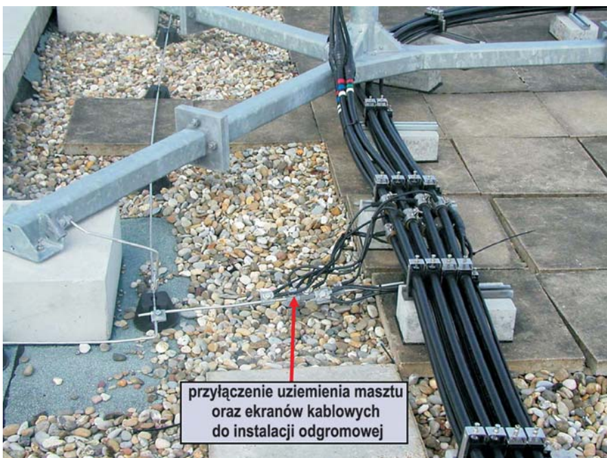
Rys. 1. Brak zachowania odstępu izolacyjnego na stacji bazowej telefonii komórkowej
