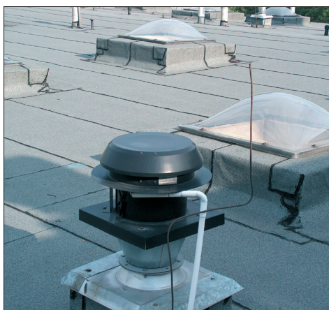
Fot. 2 Przykład niezachowania odstępów izolacyjnych
