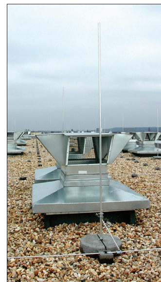
Fot. 1 Ochrona urządzeń na dachach budynków za pomocą zwodów pionowych – rozwiązania firmy DEHN
