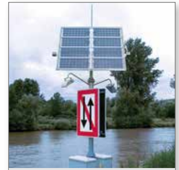
Rys. 1. Przykład instalacji PV na wolnym powietrzu – autonomiczny układ zasilania oświetlenia znaków żeglugowych
