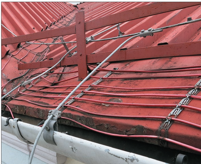
Fot. 3. Niezachowany odstęp izolacyjny w warunkach rzeczywistych
