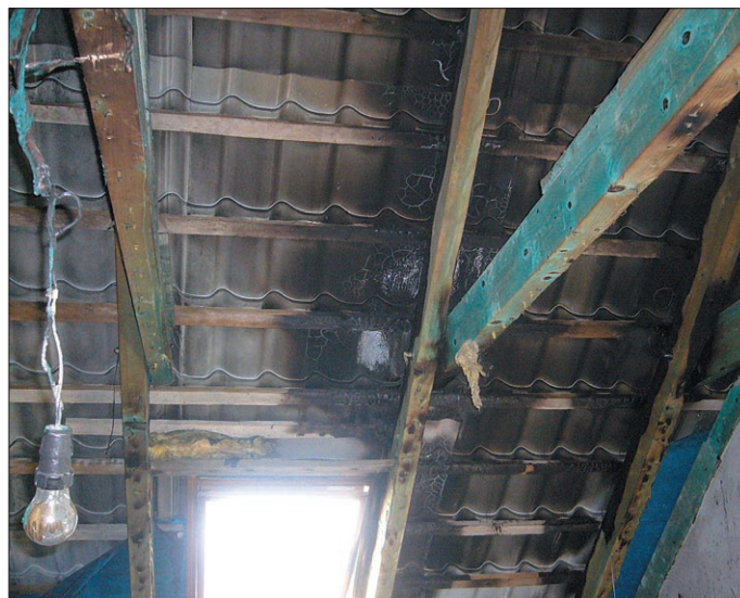
Fot. 4. Zniszczona instalacja elektryczna w wyniku przeskoku iskrowego spowodowanego brakiem odstępu izolacyjnego
