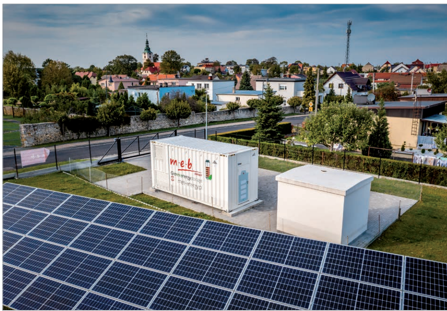
Rys. 11. Instalacja fotowoltaiczna z magazynem energii w Kamieniu Śląskim [1]
