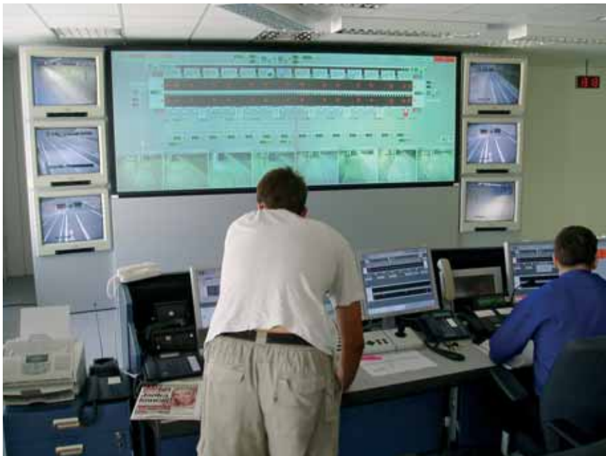
Rys. 2. Centralny system sterowania tunelu
