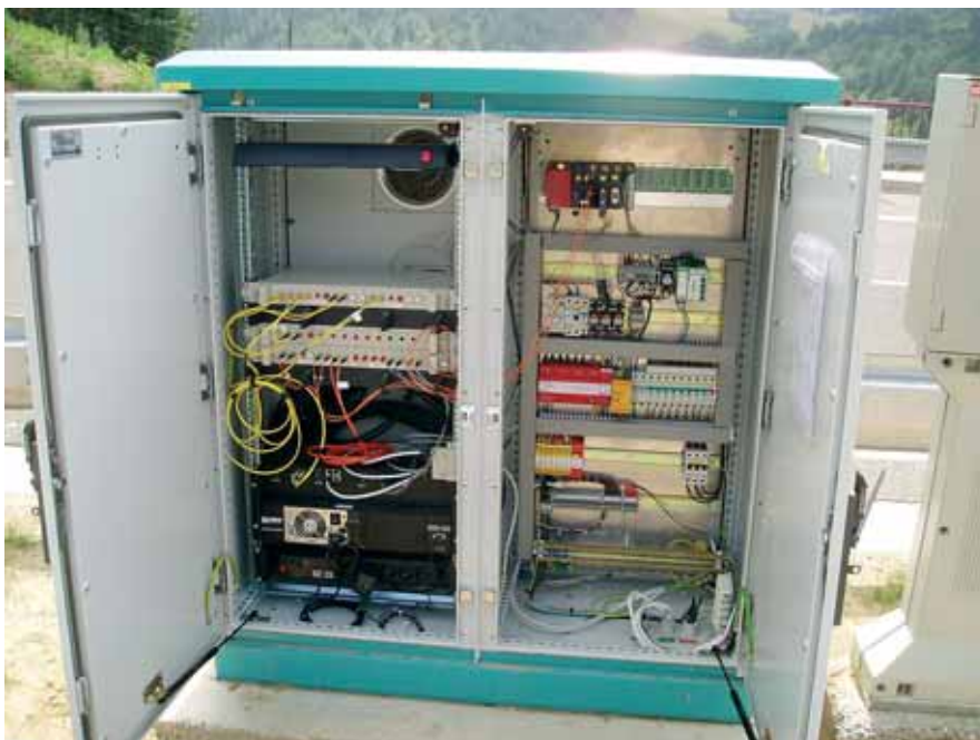
Rys. 3. Szafa rozdzielcza z ochroną przeciwprzepięciową DEHN
