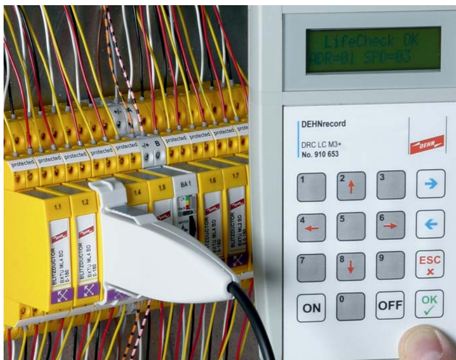
Rys. 6. Kontrola ograniczników Blitzductor XTU za pomocą testera DEHNrecord LC M3+
