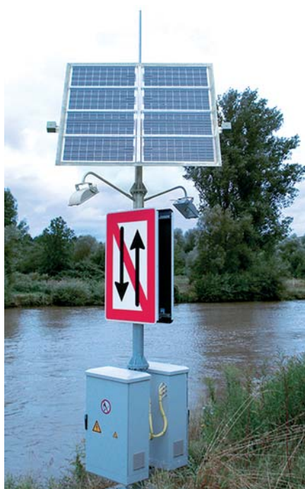
Rys. 1. Autonomiczny układ zasilania instalacji fotowoltaicznej zamontowany nad brzegiem rzeki
