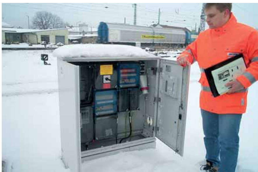
Rys. 4. Urządzenia Dehn chronią instalacje zasilania stacji bazowych GSM-R niemieckich kolei DB
