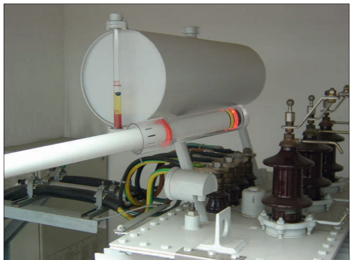
Rys. 3. HSA 205 przy transformatorze
