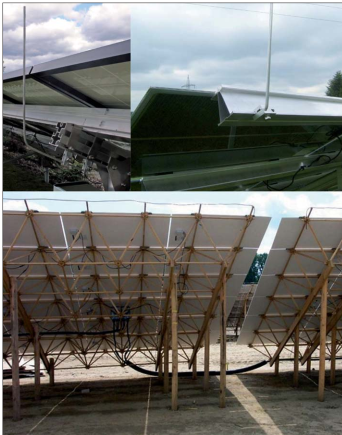
Fot. 3. Ochrona elementów systemu fotowoltaicznego przed bezpośrednim wyładowaniem piorunowym [10]
