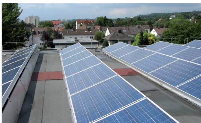
Fot. 1. Kolektory fotowoltaiczne na płaskim dachu obiektu budowlanego [10]
