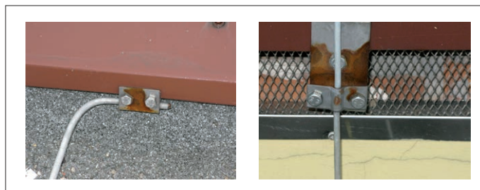
Rys. 1. Przykładowy wygląd elementów mocujących po ok. 2 latach od wykonania LPS (przedmieścia Warszawy)
