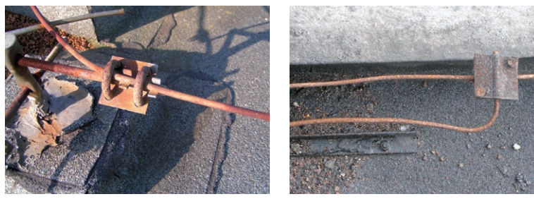
Rys. 5. Wygląd urządzenia piorunochronnego, który nie podlegał pracom konserwacyjnym
