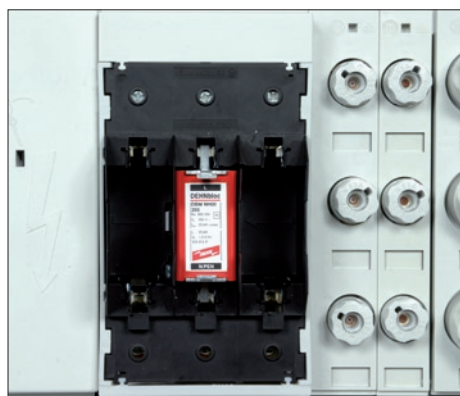
Fot. 2. Przykład montażu ogranicznika DBM NH00 255 w układzie sieci TN-C
