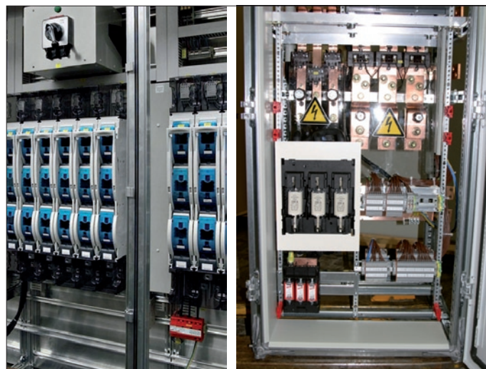
Fot. 1. a) Rozdzielnica przemysłowa z SPD zamontowanym na szynie TH 35 mm, b) rozdzielnica z SPD zabudowanym w podstawach bezpiecznikowych
