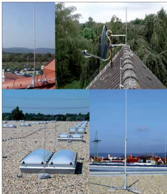
Fot. 1. Różnorodne zwody na dachach obiektów budowlanych
