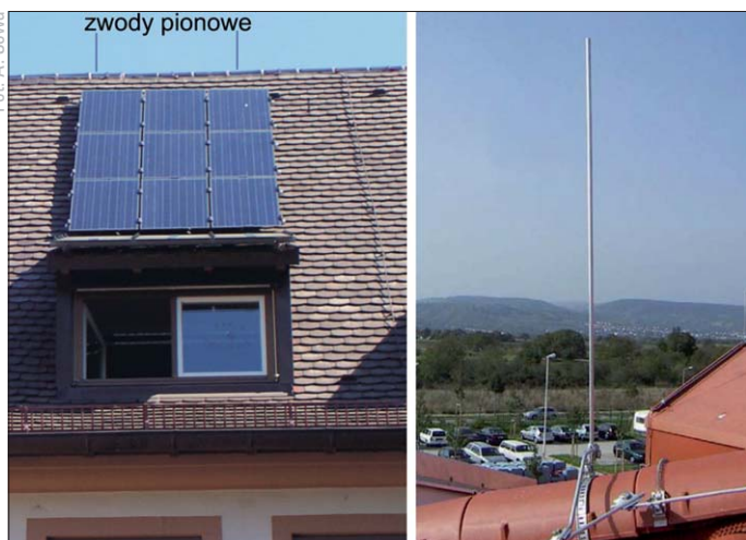
Fot. 2. Ochrona odgromowa kolektorów fotowoltaicznych na dachu obiektu budowlanego
