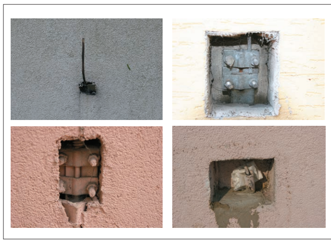
Rys. 1. Przykłady złączy kontrolnych na ścianach docieplanych budynków – efekt braku współpracy pomiędzy wykonawcą termoizolacji oraz elektrykiem odpowiedzialnym za instalację piorunochronną
