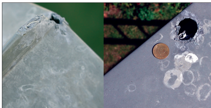
Fot. 3. Uszkodzenia spowodowane przez prąd piorunowy przy bezpośrednim wyładowaniu w budynek (system rejestracji BLIDS-SIEMENS I=20400 A)
