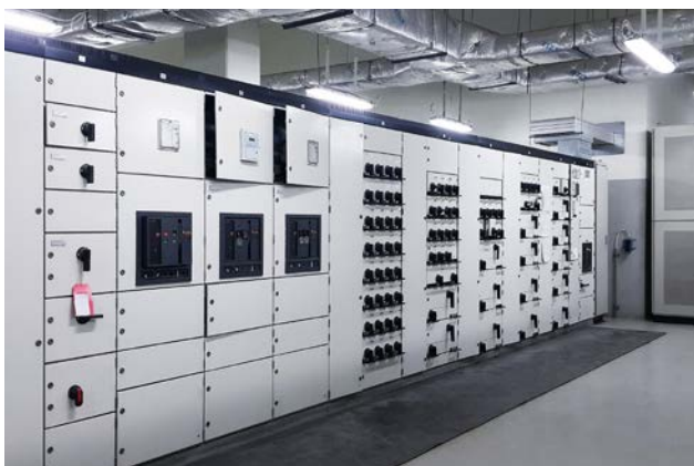
Przemysłowe rozdzielnice niskiego napięcia
