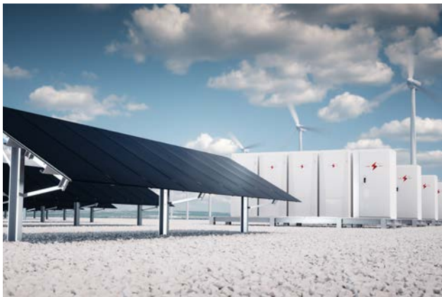
Instalacje odnawialnych źródeł energii
