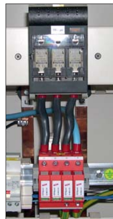
Fot. 1. Przykład dobezpieczenia ogranicznika przepięć typu 2 w rozdzielni
