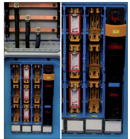
Fot. 3. Montaż ogranicznika VNH w szafie rozdzielczej
